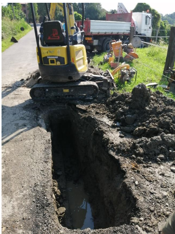
Tubazione rete acquedotto
