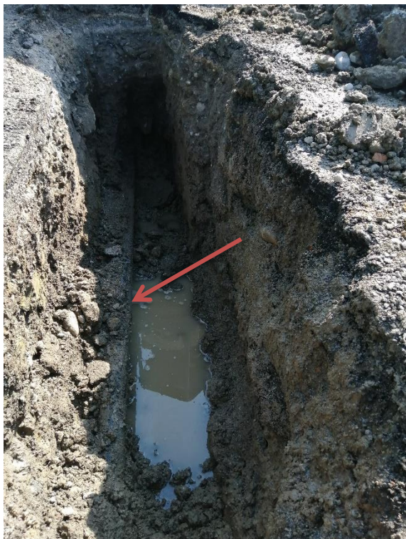
Tubazione rete acquedotto
